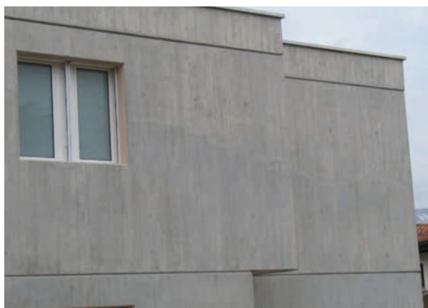
Ripresa di getto orizzontale ed inevitabile difettosità cromatica della superficie di una parete in calcestruzzo armato.
