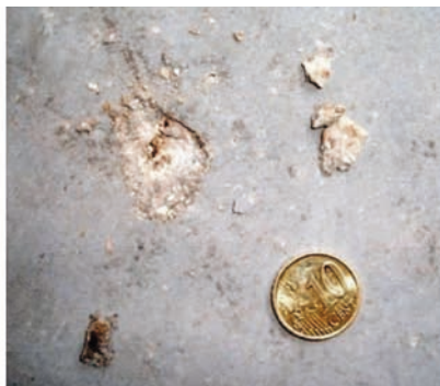
Reazione alcali-aggregato in una pavimentazione in calcestruzzo.
