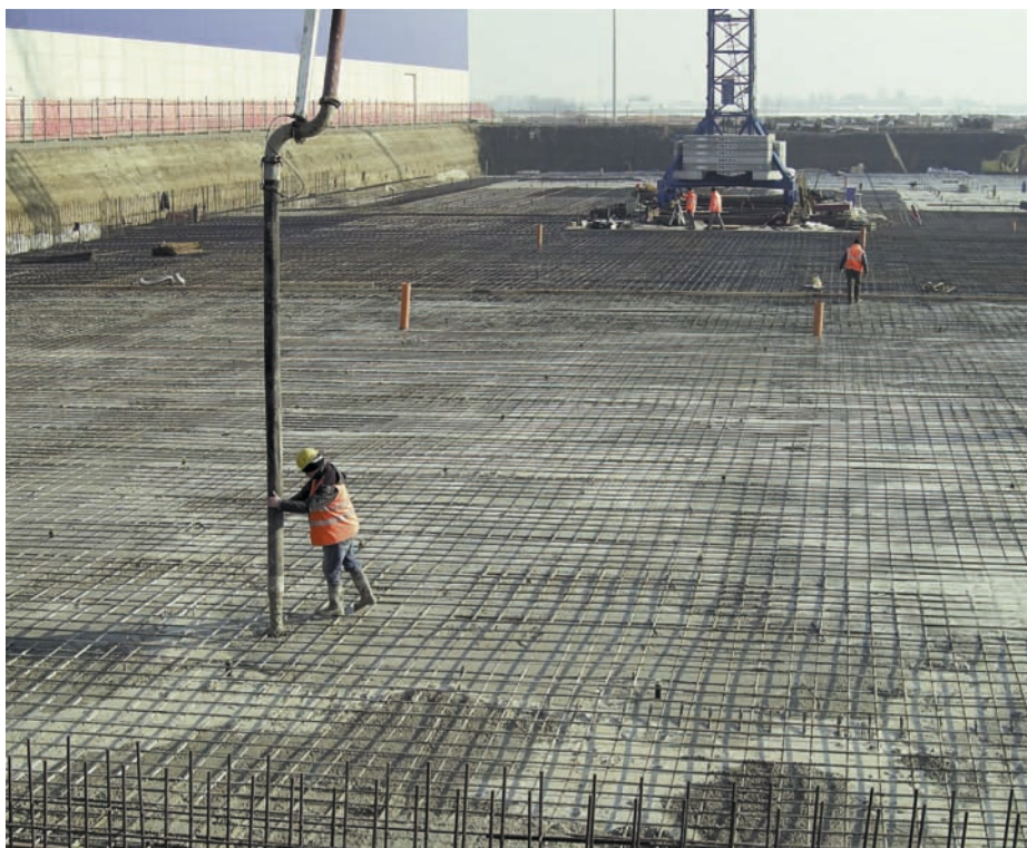
Getto Pavimentazione - Ikea Deposito Centrale 2 - Piacenza. Realizzazione di una fondazione a platea di grande estensione superficiale. Si noti la porzione di struttura di calcestruzzo già indurito (quella ricoperta con foglio di polietilene) e quella in corso di realizzazione
